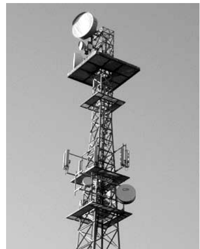
Een UMTS-mast: verzonken kosten
